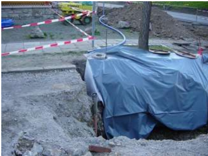
Bild 1: Flatterband ist zur Sicherung von Aufgrabungen nicht zulässig
